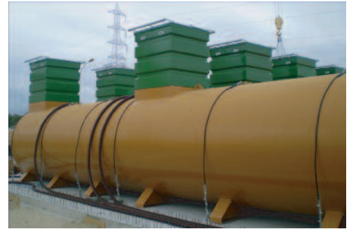
Stockage double paroi
